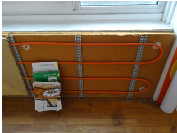
Figuur 21 Isolatie met houtvezels.
